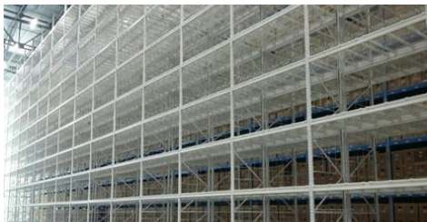
Iron Mountain 项目、下诺夫哥罗德、萨马拉
